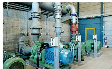
Moteur synchrone à réluctance dans l'usine de Kaisten : réalisation (2 e étape, 55 kW).
