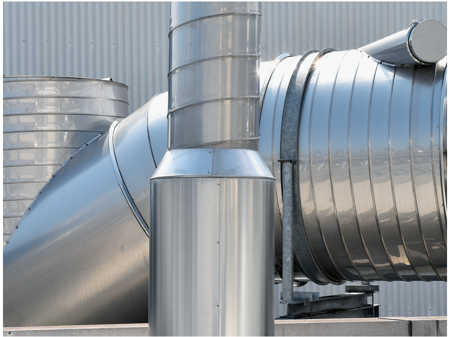
Gestion de l'air évacué sur le toit de Givaudan.
